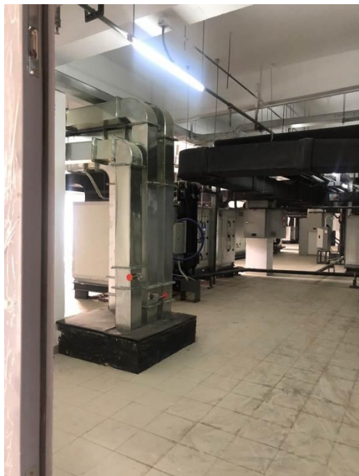
复合手术室上方空调设备间
